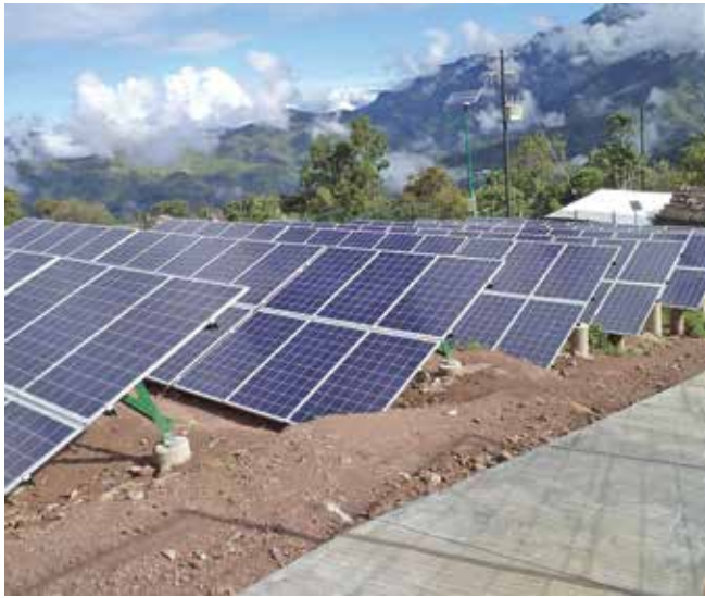
Central Fotovoltaica. Fuente: SEMARNAT, 2012
