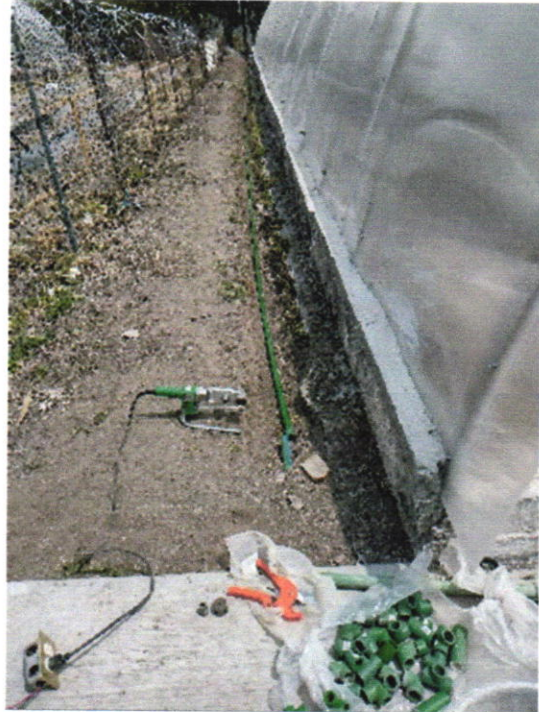
Tendido y termo fusionado de tubería y accesorios de PPR en línea principal
