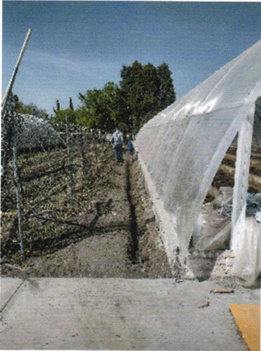
Excavación de zanja para la instalación de tubería de PPR (tubo plus)
