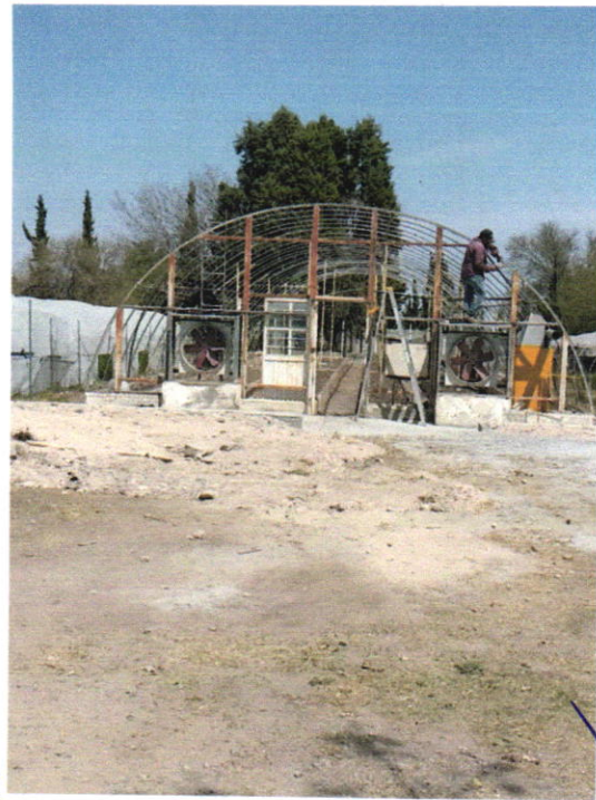
Extractores helicoidales sin funcionar y de bajo volumen de extracción de masa de aire
