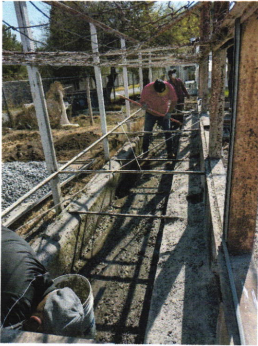
Una vez desmontado y limpia toda el área, se procedió a la demolición de la estructura para su remodelación
