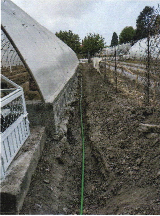
Interconexión de red de línea a pileta
