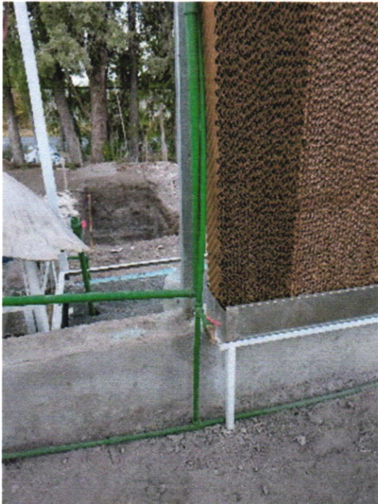
Conexión de red a llenado de tinacos y grifo
