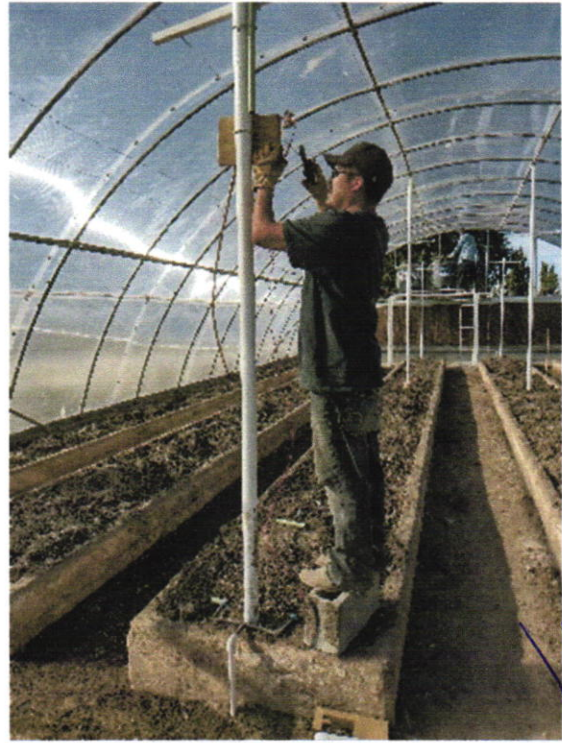
Conexión de sensores de control de temperatura
