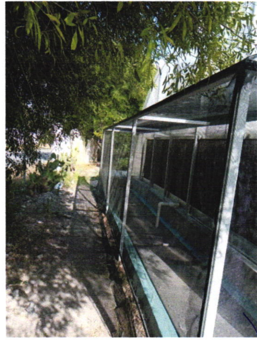
Cubierta de malla en pared de húmeda
