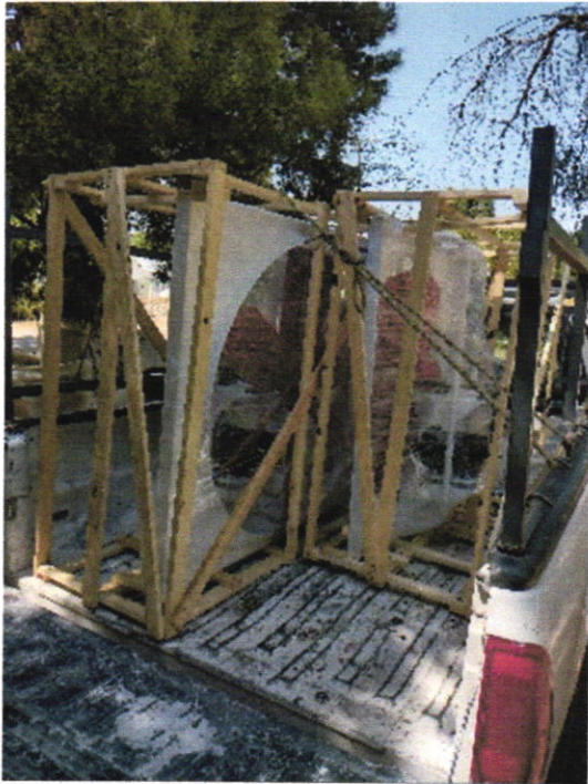
Recepción de nuevos extractores, de mayor dimensión y extracción
