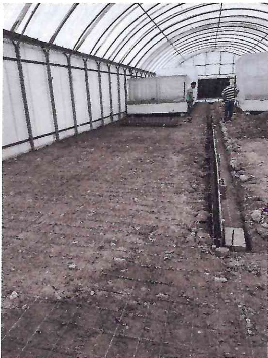
Y POSTERIORMENTE, SE REALIZÓ EL TENDIDO DE LA MALLA ELECTROSOLDADA Y ENCOFRADO DEL MISMO
