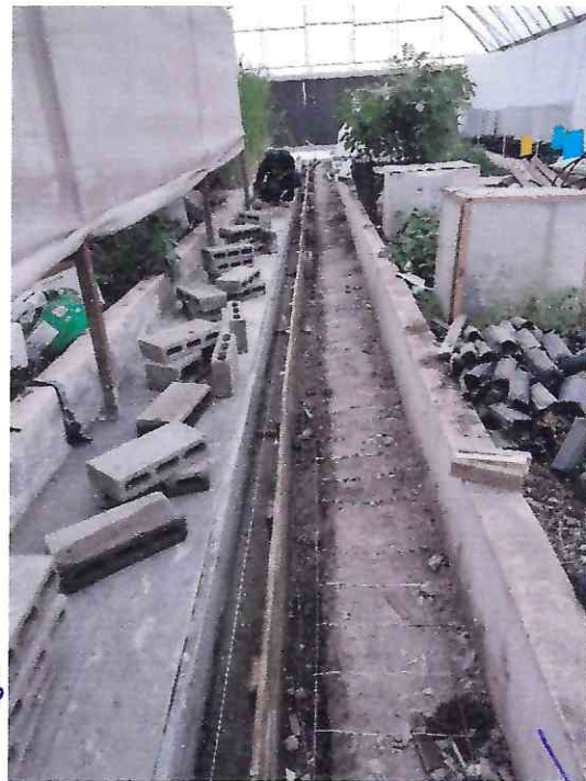
TENIENDO LISTO LOS MATERIALES SE PROCEDE AL ENCOFRADO CON MADERA, DEJANDO UN DESAGUE DE 0.23 MTS A LO LARGO DEL TUNEL
