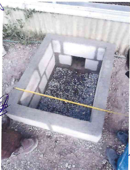
REGISTRO DE CAPTACION DE ESCURRIMIENTO Y FILTRACION
