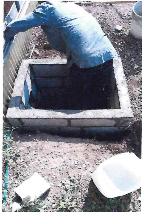
RECOLECTA DE LIQUIDO PARA INFILTRACION
