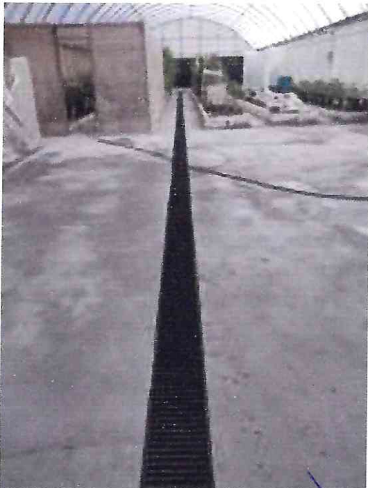
PASILLO DE CANAL DE ESCURRIMIENTO CON REJILLAS
