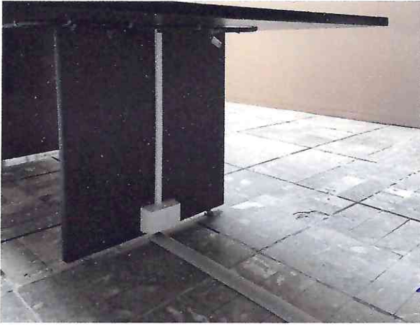
INSTALACION ELECTRICA EN MESA DE SALA
