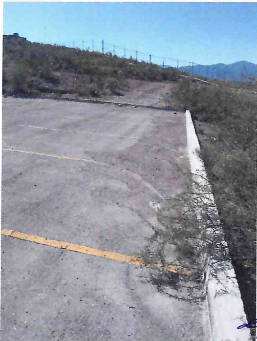
LINEAS DE ESTACIONAMIENTO PRESENTAN DEGRADACION DEL COLOR Y FALTA DE TOPES VEHICULARES
