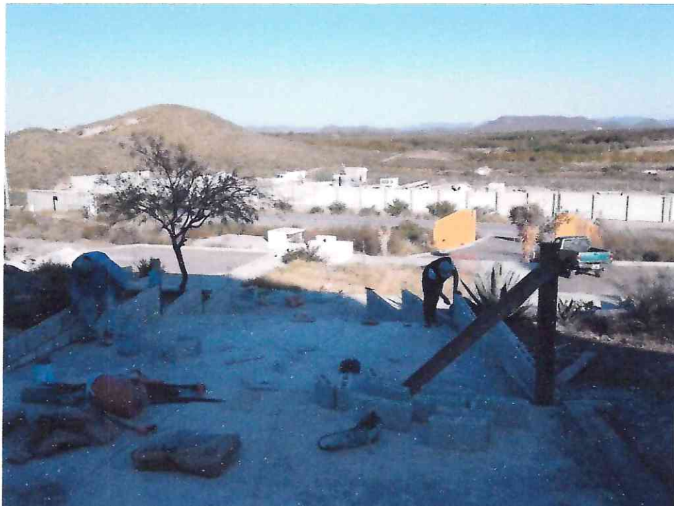
AVANCE DE AMBOS LADOS, CON LAS MISMO CALIDAD DE MATERIALES Y PREPARACIONES PARA EL ASENTADO DE BLOCK
