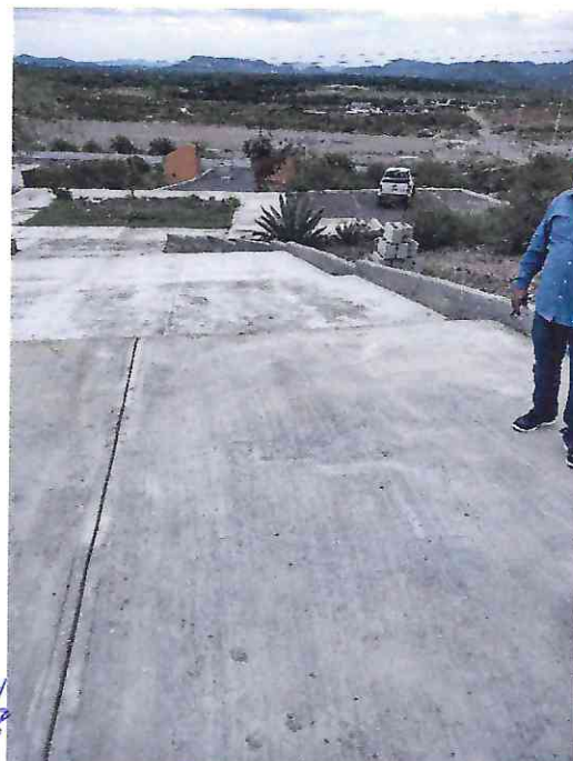
MURETES Y GRADAS DE LADO DERECHO EN ENTRADA, PROBLEMA DE MAL ACABADO Y PROP. DE MATERIAL
