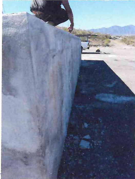
MURO DE JARDINERA, CON PROBLEMAS DE FILTRACION Y PRESENTA MANCHAS DE HUMEDAD
