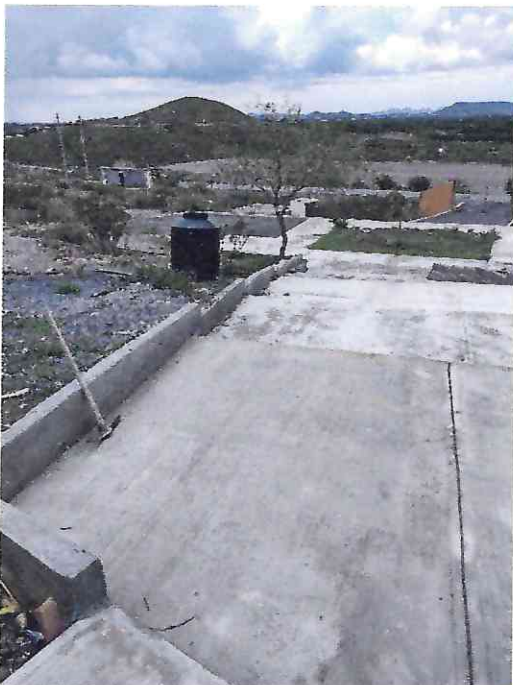
MURETES Y GRADAS DE LADO IZQUIERDO EN ENTRADA, PROBLEMA DE MAL ACABADO Y PROP. DE MATERIAL
