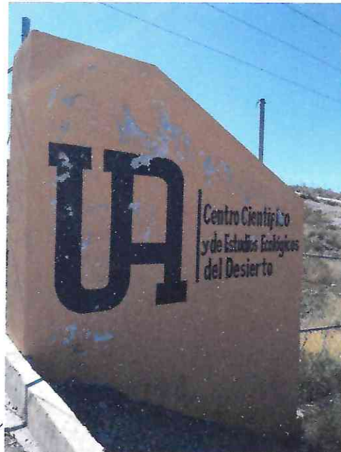
MURO ENTRADA PRINCIPAL LADO DERECHO, PRESENTA PROBLEMAS DE DESMORONAMIENTO
